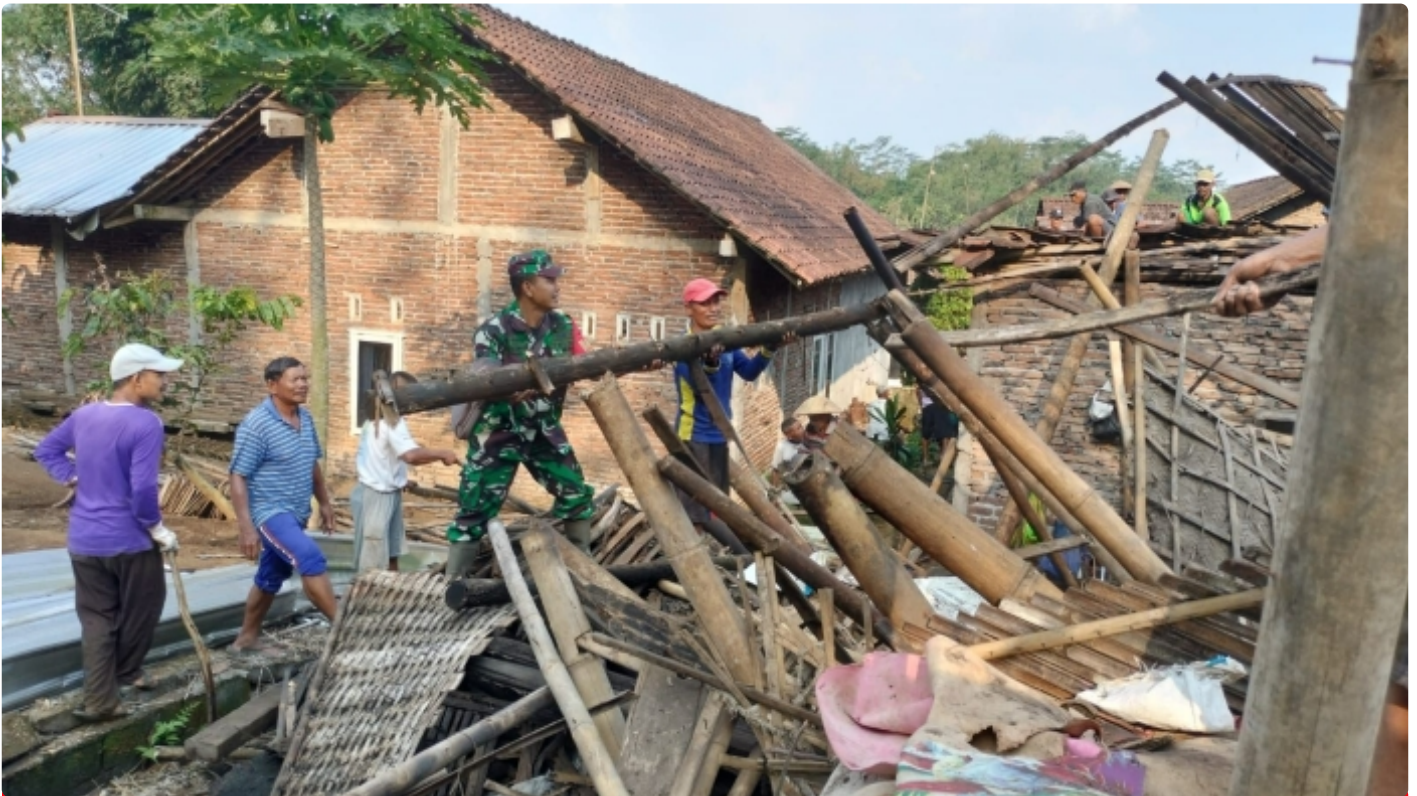
Babinsa Desa Rejosari Sertu Slamet Ariyanto Bersama Masyarakat, Membantu Perbaikan Rumah Warga Yang Rusak Akibat Hujan Disertai Angin Kencang di Dusun Gedowo Rejosari
